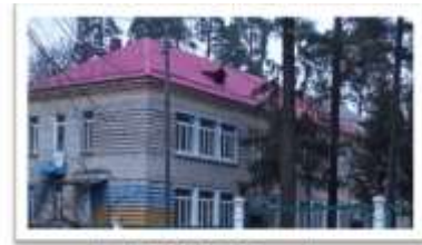
Ремонт покрівлі ДНЗ № 703 (замінено покриття із шиферу на покриття з металопрофілью площею 440 м 2 )
